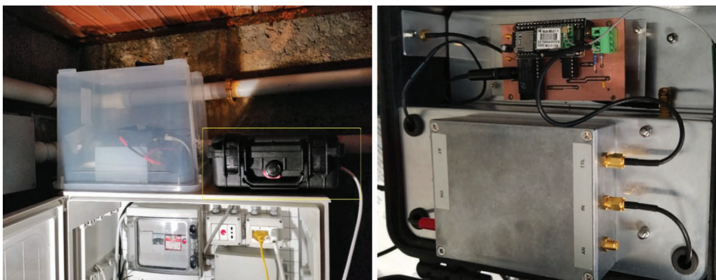
Figura 3 Stazione sismica SRES installata nella galleria-bunker del Monte Soratte, montagna nella provincia di Roma, nel mezzo della valle del Tevere. La valigetta nera contiene il sensore radon e l'acquisitore. A destra viene mostrato l'interno della valigetta dove è visibile lo strumento Lucas Cell in telecontrollo (ved. Cannelli et al. [2020]).
